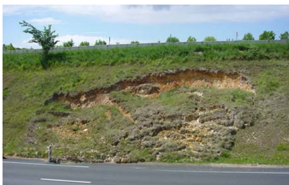
Instabilité dans les formations meubles : le talus est trop raide
