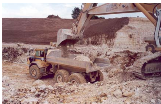
Cas des déblais de Gien : raidissement des talus dans la craie
